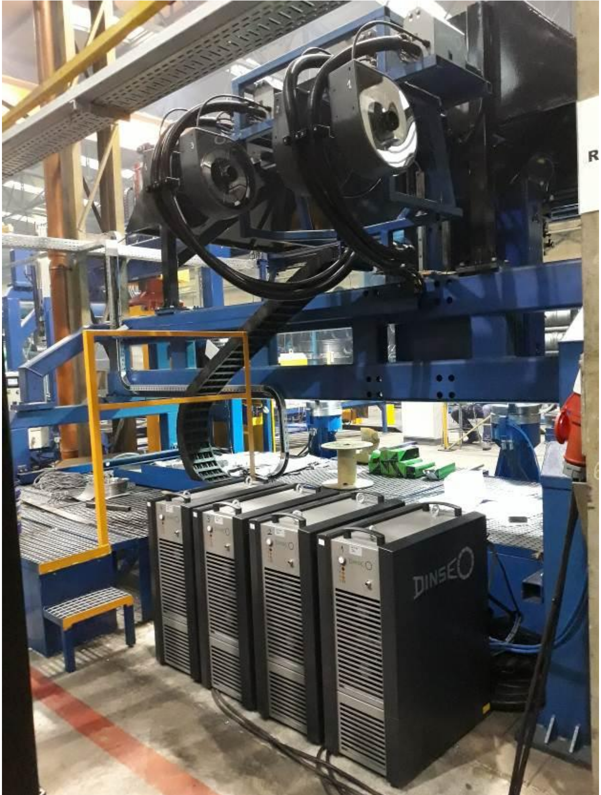
Produktionsanlage mit vier Power Invertern DIX PI 500.
